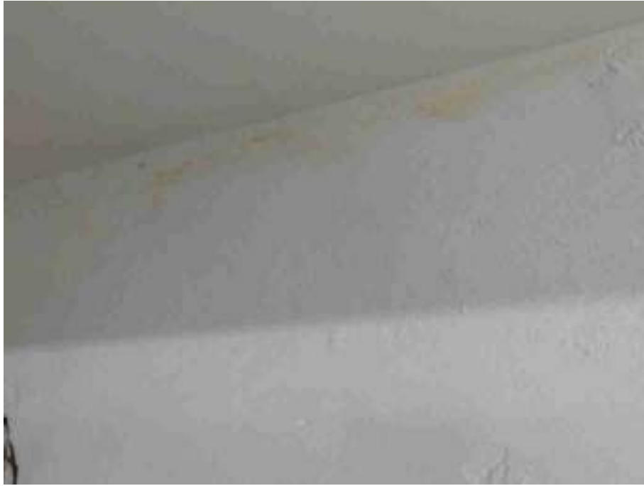
Fot nr 14 Widok zawilgoceń ściany.
