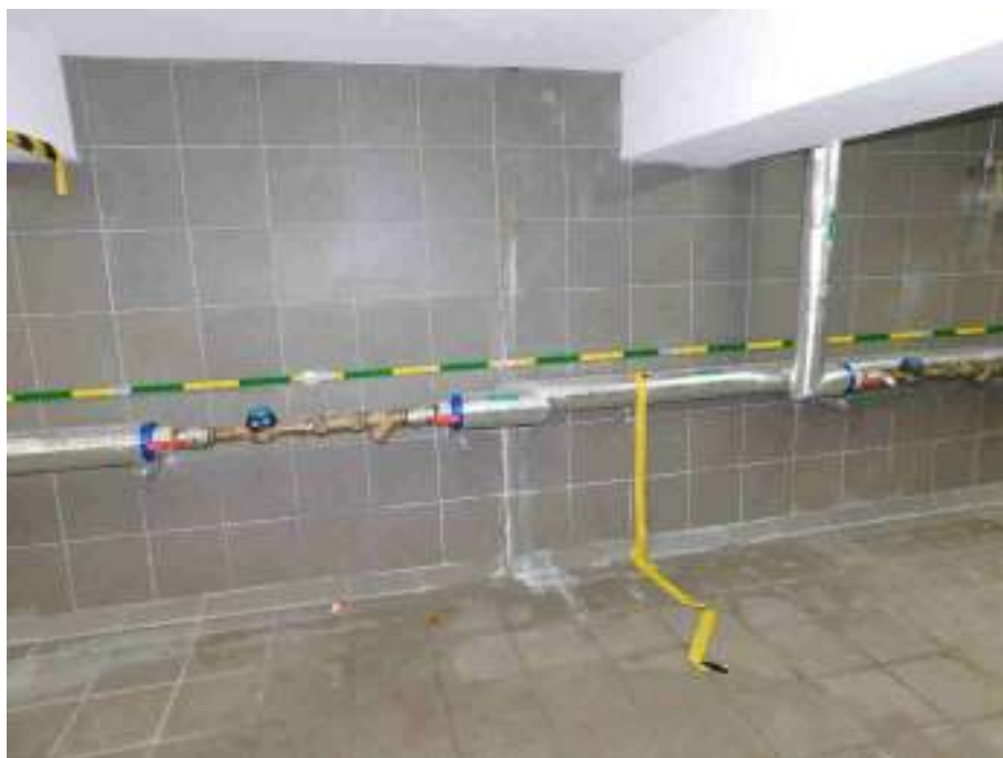
Fot nr 7 Widok zawilgoceń ściany.
