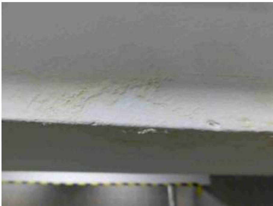
Fot nr 9 Widok przecieków przez strop.
