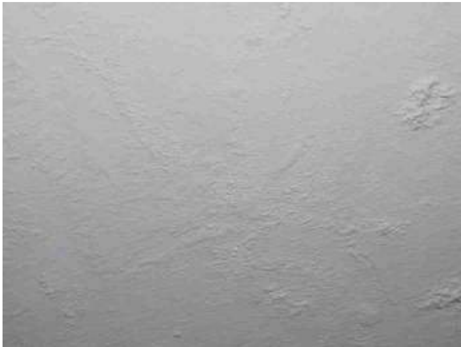
Fot nr 6 Widok przecieków przez strop.
