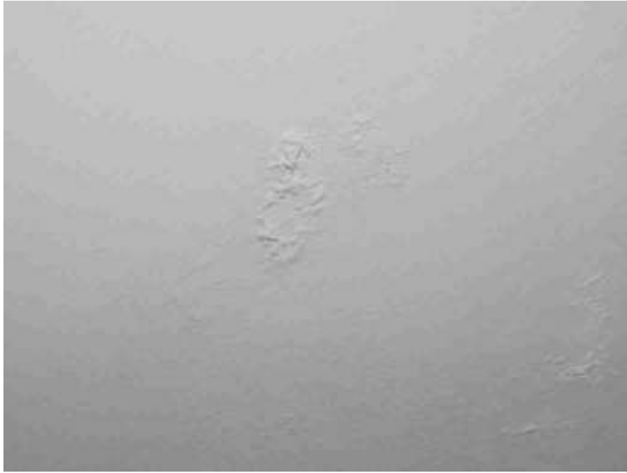
Fot nr 5 Widok przecieków przez strop.
