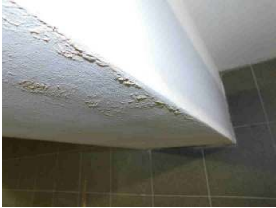
Fot nr 10 Widok przecieków przez strop.
