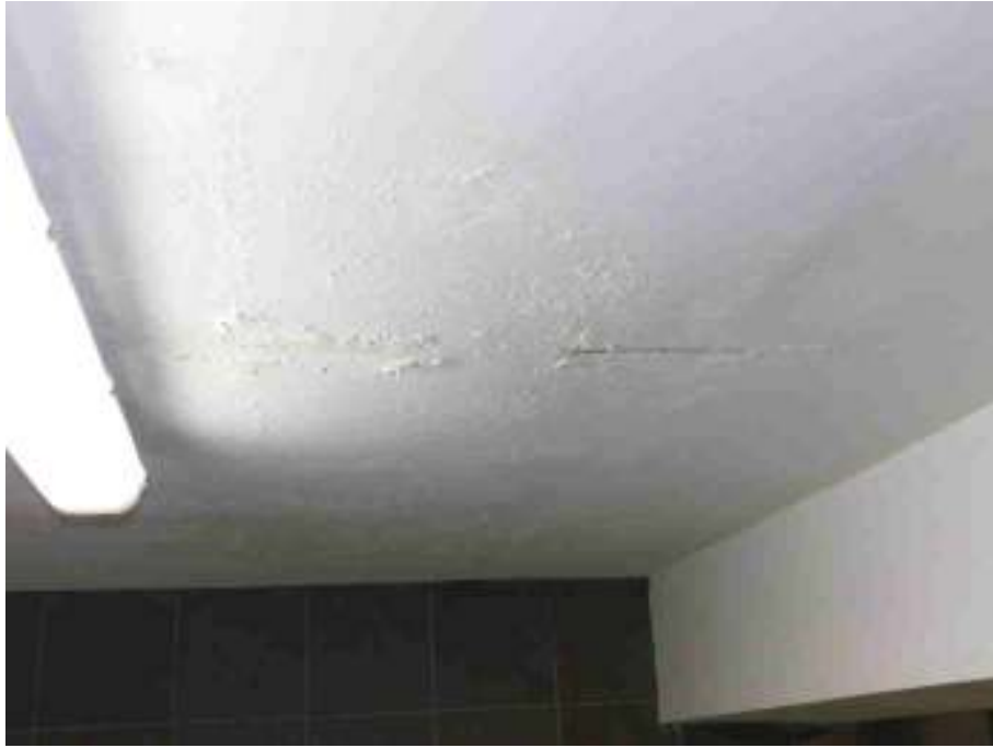
Fot nr 8 Widok przecieków przez strop.
