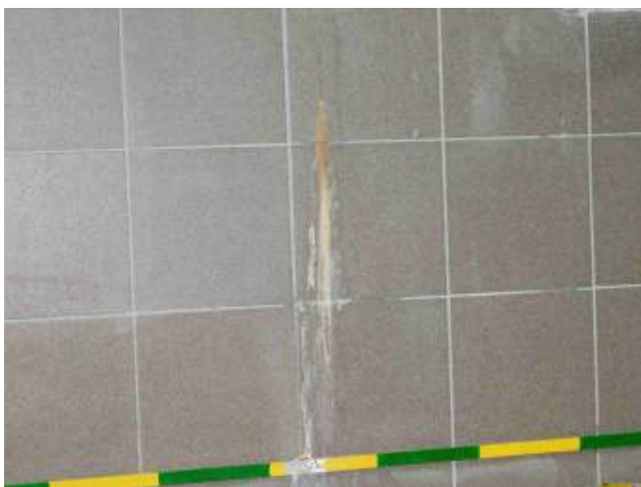
Fot nr 7 Widok zawilgoceń ściany.
