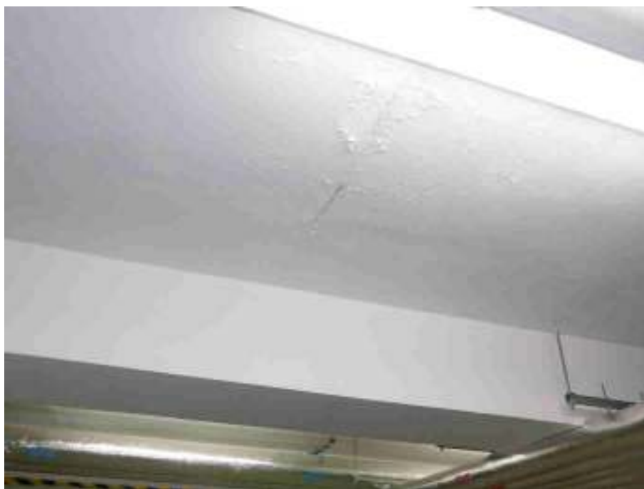
Fot nr 4 Widok przecieków przez strop.
