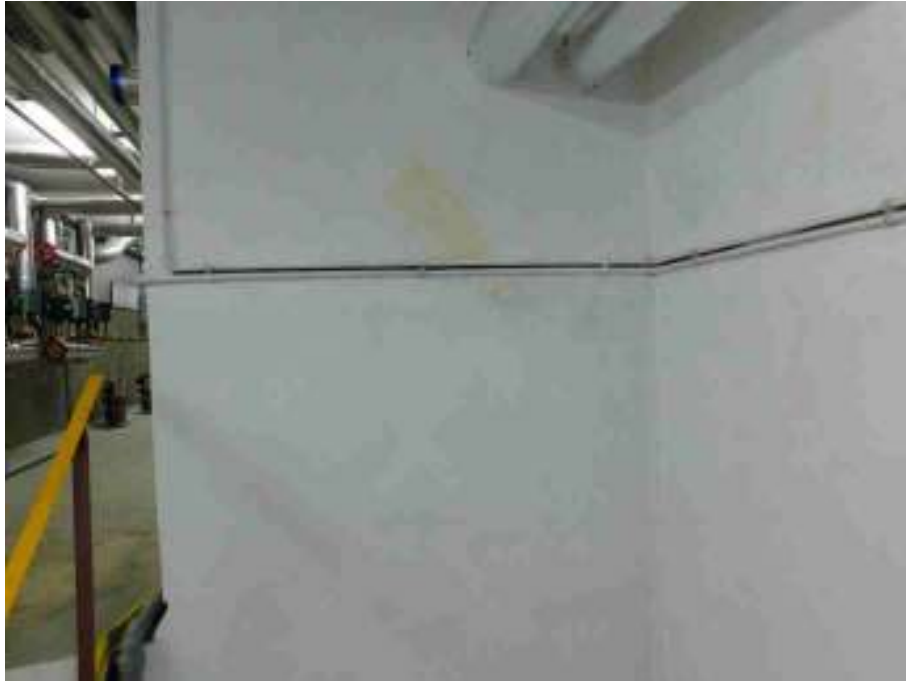
Fot nr 12 Widok zawilgoceń ściany.
