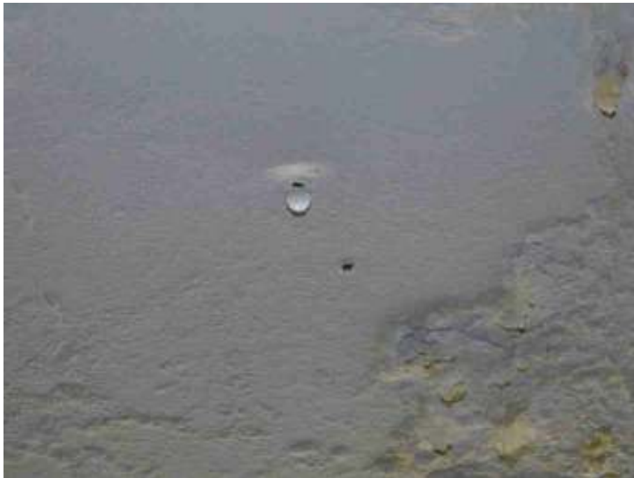
Fot nr 11 Widok przecieków przez strop woda kapie ze stropu
